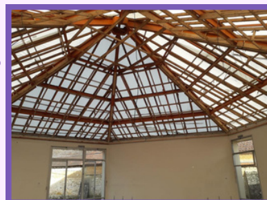
Charpente d'une salle de classe mise à nu
